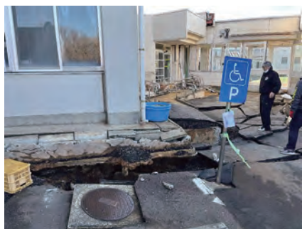
建物の基礎部分の陥没
